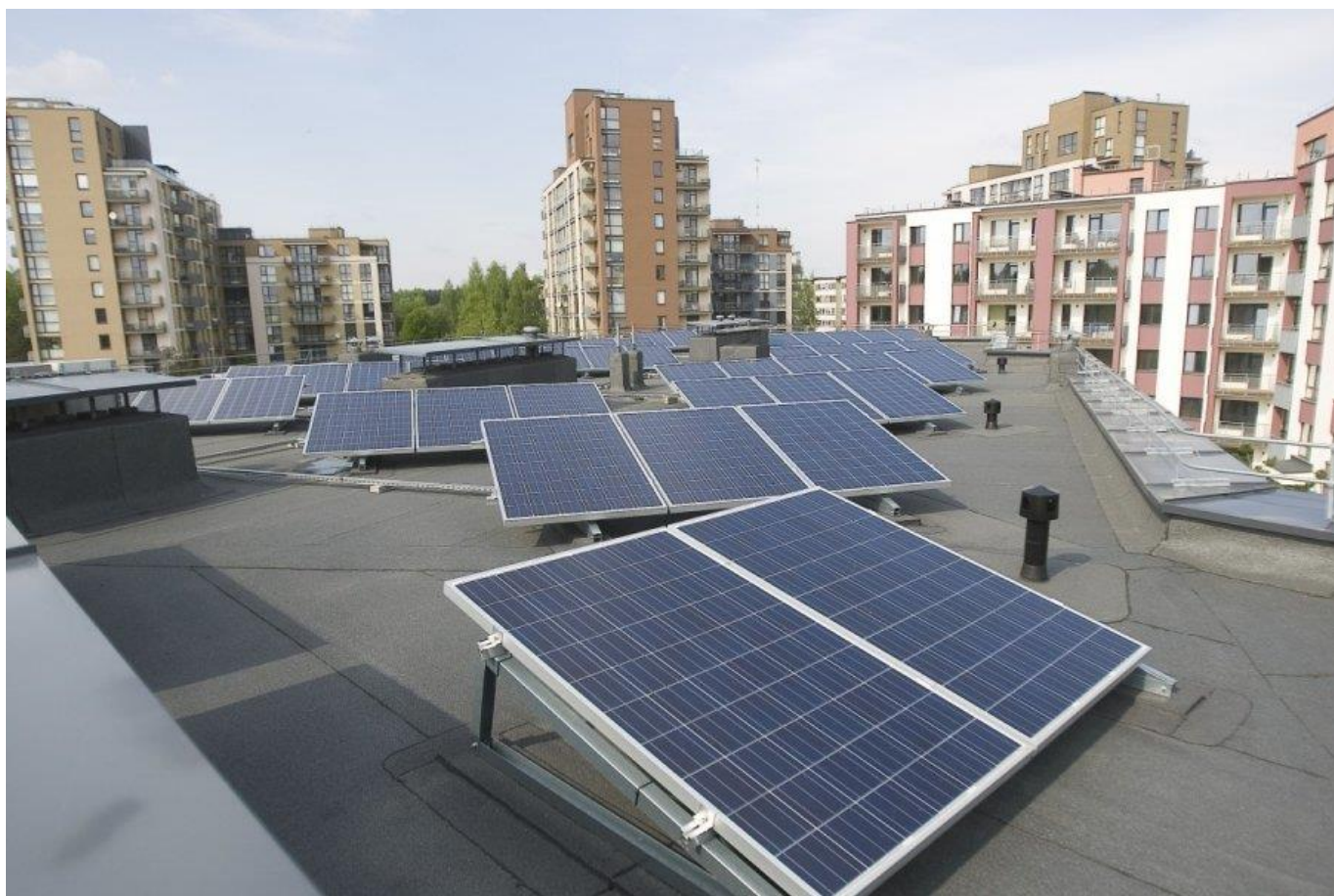
41 paveikslėlis. Saulės elektrinės pavyzdys ant daugiabučio namo stogo Vilniuje
